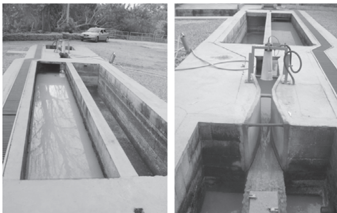
Figura 3.31 Detalhe de uma caixa de areia com limpeza manual, tendo uma calha Parshall como controlador da velocidade do escoamento.
