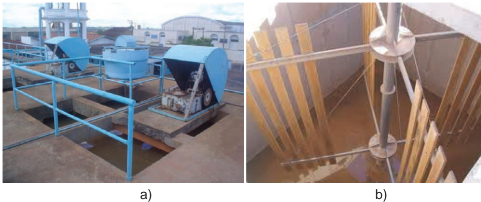
Figura 2.43: Floculadores mecânicos: (a) vista geral; (b) paletas paralelas ao eixo – ETA (Bebedouro – SP)
