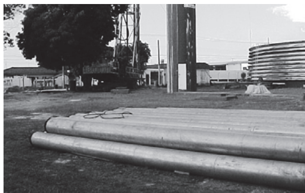
Figura 2.16 Tubulações a serem empregadas no revestimento – após a perfuração do poço.
