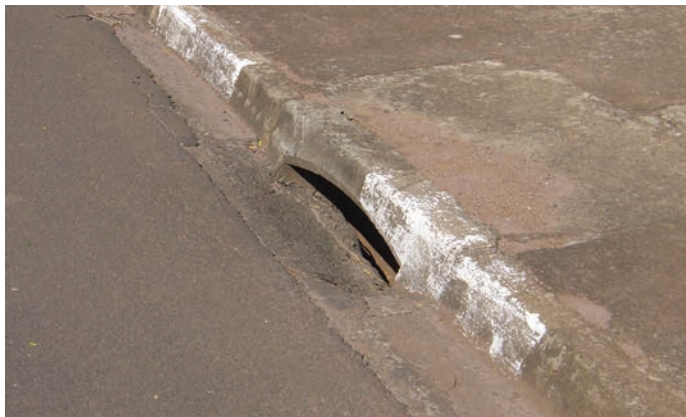
Figura 4.18 Boca de lobo sem grades e com depressão na sarjeta.
