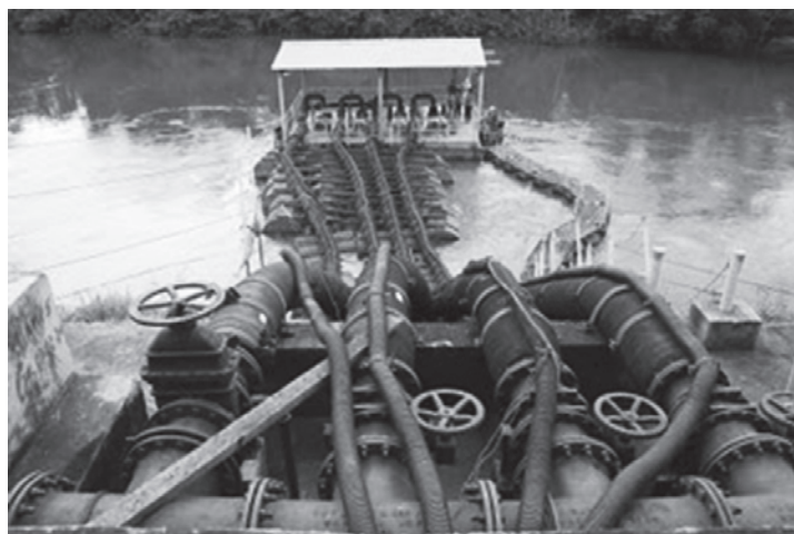
Figura 2.18 Sistema de captação flutuante – Rio Paraúpebas (MG).
