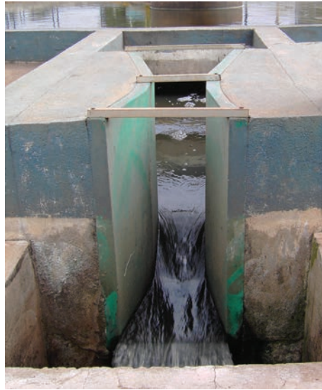
Figura 1 - Vista da calha Parshall.
